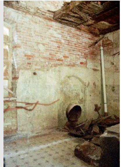
Turbinenraum mit Turbinenrohr, durch das das Wasser strömen wird
